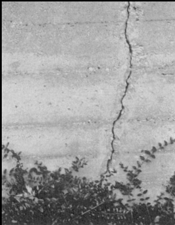
Fissura na parede
