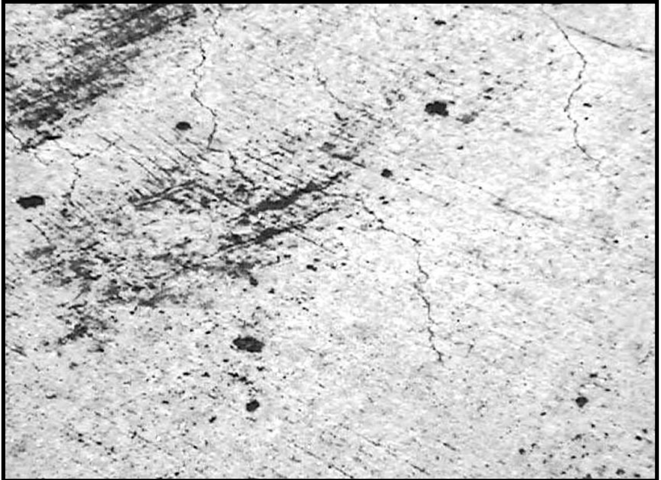
Figura 13: Fissura de Retração Plástica
