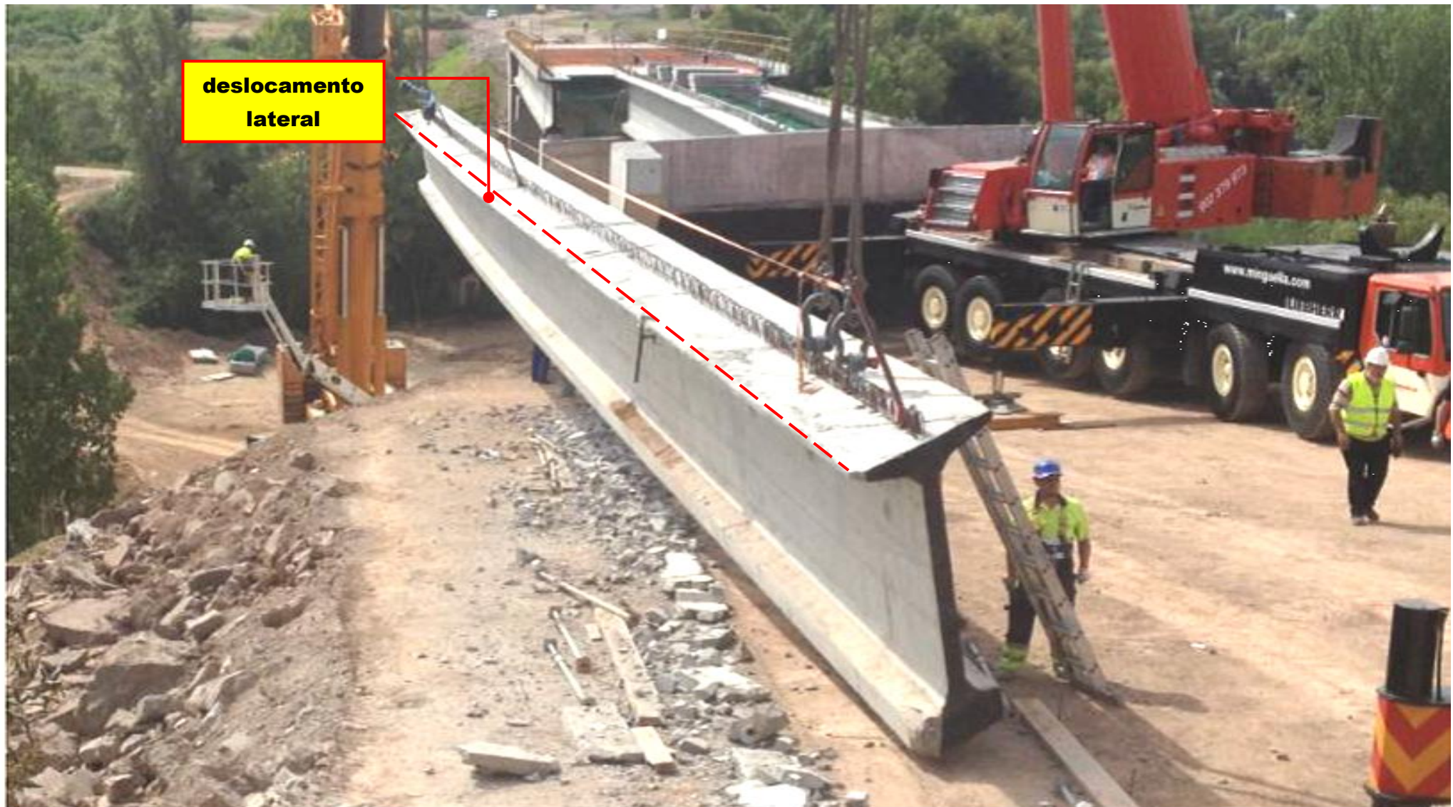
Viga com instabilidade lateral
