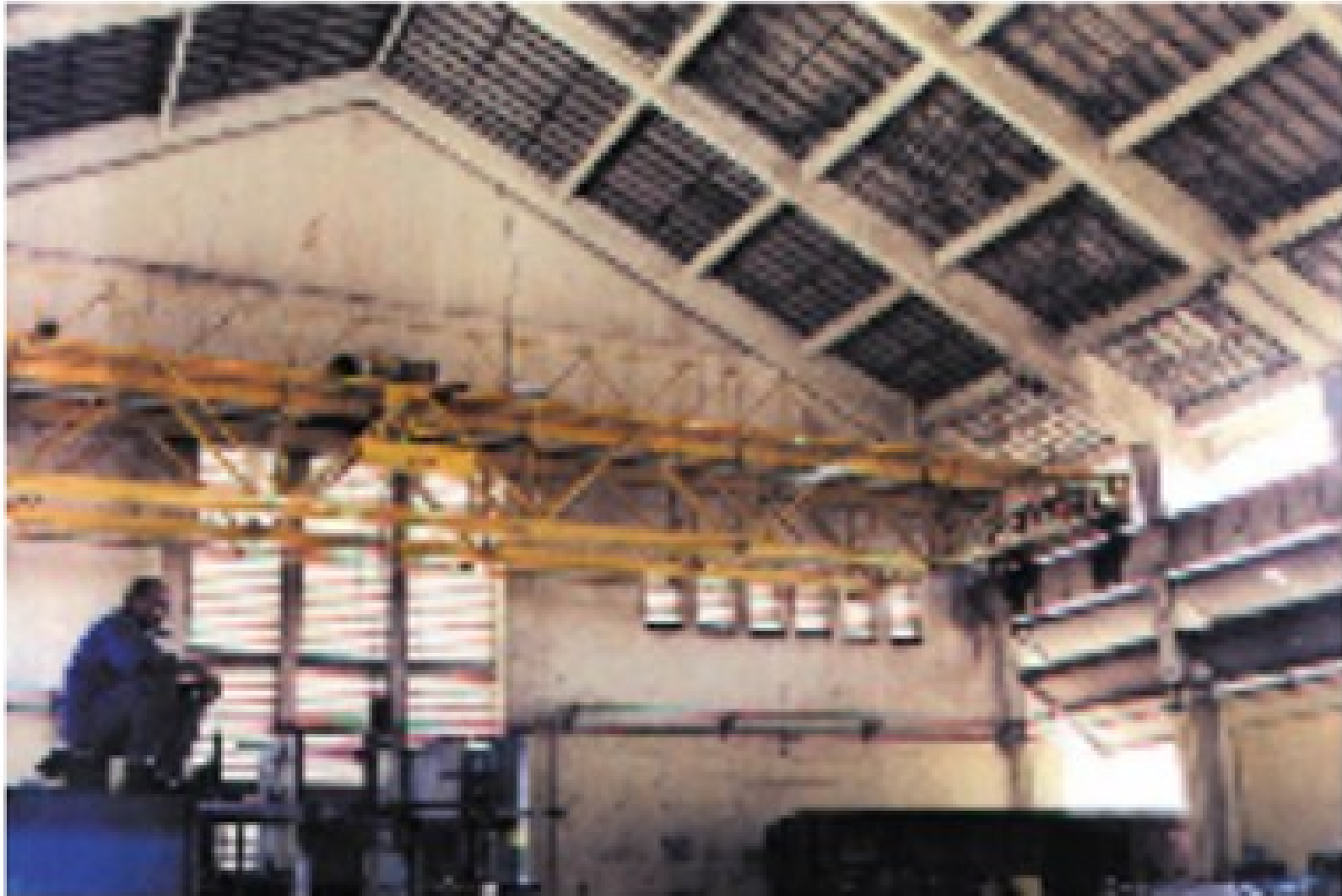
Ponte rolante para 30 toneladas
