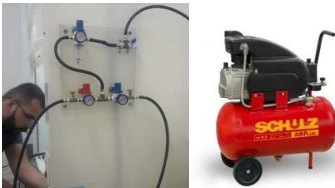
Figura 36 – Linhas de ar comprimido e fonte de ar utilizada.
