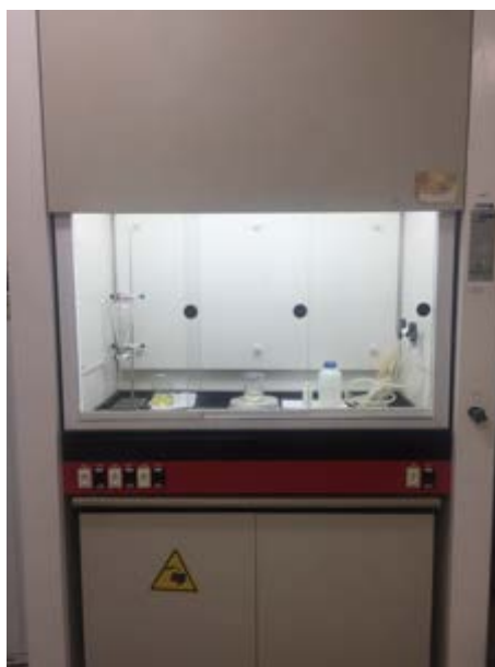
Figura 34 – Ambiente de exaustão exclusivo montado.
