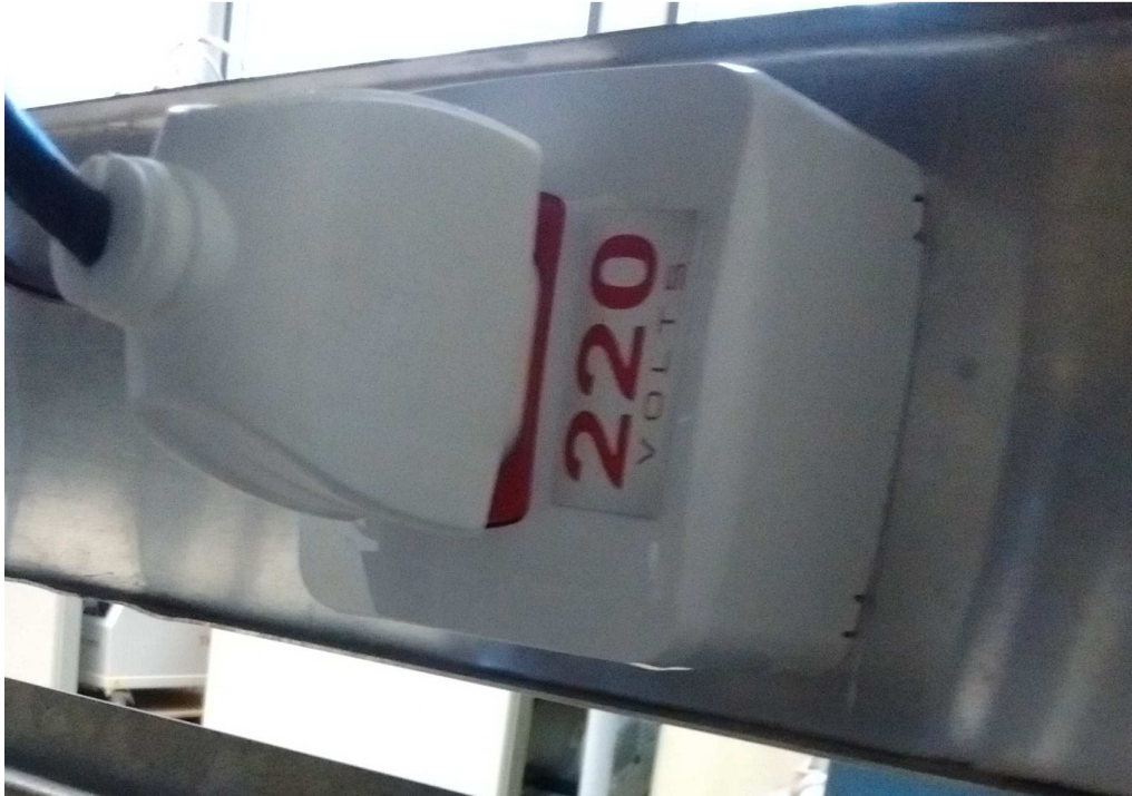
FIG 4.8 Fotografia da conexão de ligação do circuito elétrico utilizando duas fases de tensão (R e T) instalado fora do circuito elétrico.
