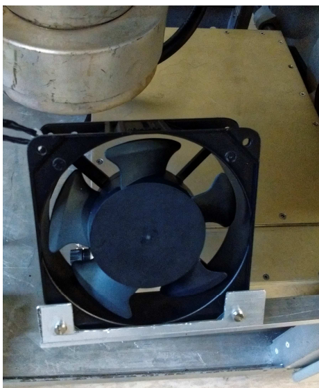
FIG 6.3 Fotografia mostrando o eletroventilador instalado para proteção do casador de impedância.
